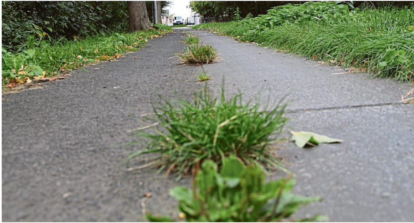
Der Radweg an der Brühler Straße von Berzdorf nach Wesseling gleicht einer Buckelpiste.
